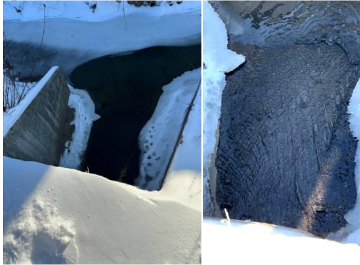
Фото 85, 86. Місце впадіння струмка в р. Тяжилівка з труби
