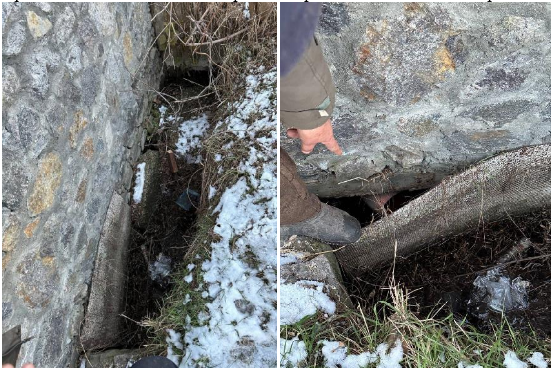
Фото 17, 18. Струмок в трубі під парканом домоволодіння
